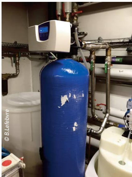
L'adoucisseur Talassa série 10.0 de 100 litres pour le circuit exclusivement destiné à la production d'ECS. On remarque le large écran de sa tête pour procéder très simplement à tous les réglages nécessaires sur l'eau et le sel.
